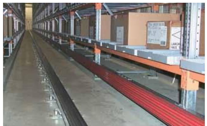
Использование системы «Продактор» для подачи электроэнергии на высокоскоростное складское оборудование
